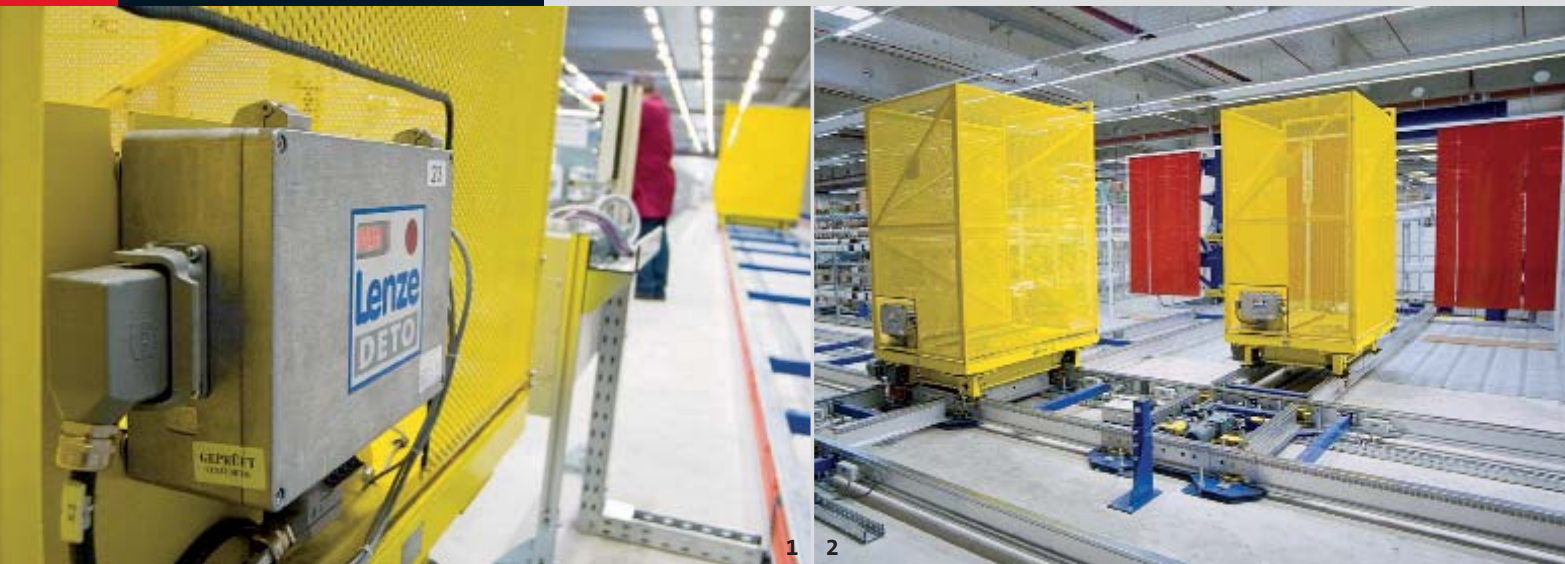
1 Im Elektropalettenbahn-System von Hella in Recklinghausen: Die durchgängig mit Steckverbindern angeschlossene Overhead Control Unit (OCU) von Lenze-Deto übernimmt die vollautomatische Steuerung des Fahrzeugantriebs. 2 Doppelschienengeführte EPB-Fahrzeuge. 3 Das Logistikzentrum von Hella in Recklinghausen.
